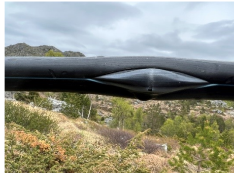
Et typisk brudd på en sommervannledning i vårlige omgivelser
